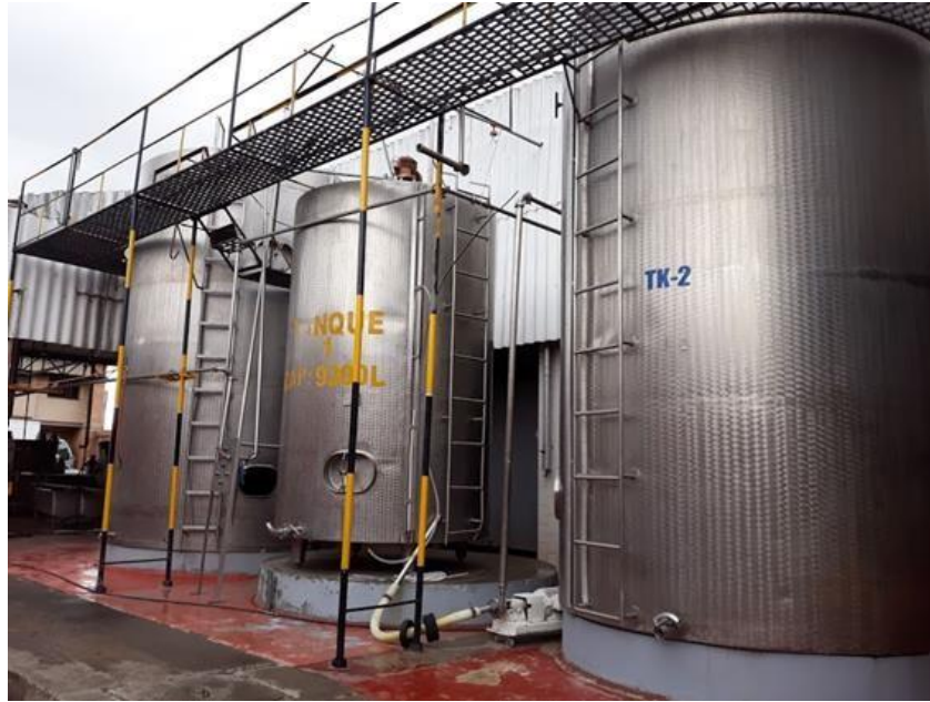
Figura 25. Tanques de almacenamiento
