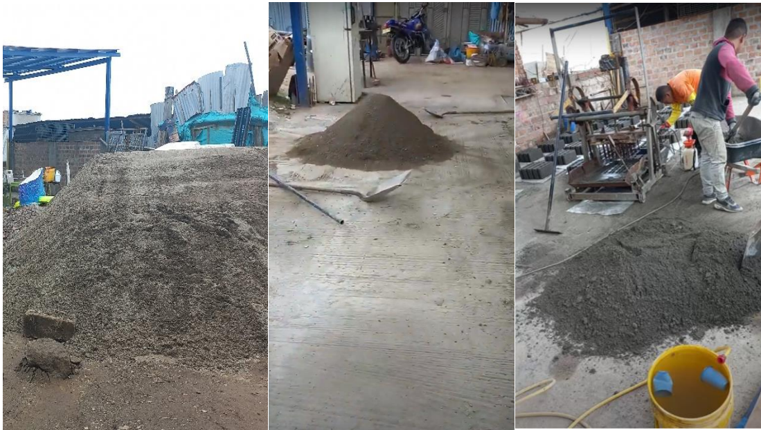
Figura 49. Elaboración de mezcla para mampuestos AGRE.H.A , (agregados de hormigón + arena natural) 76% residuos.
