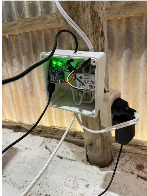
Figura 22. Implementación control de riego
