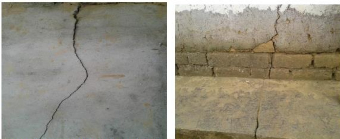
Foto 1 y 2. Grietas Casa Familiar Vivienda Familia Pillimué
