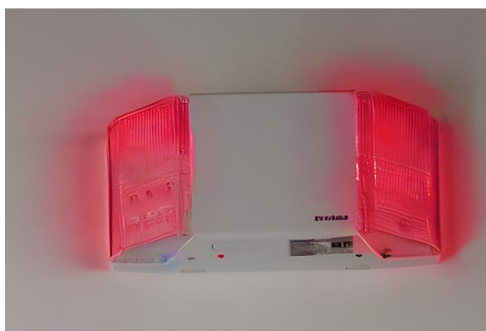
Figura 50 Señalización lumínica ante emergencias
