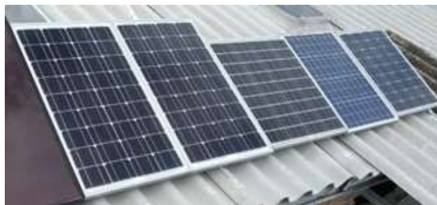
Figura 98. Paneles solares Rampa
