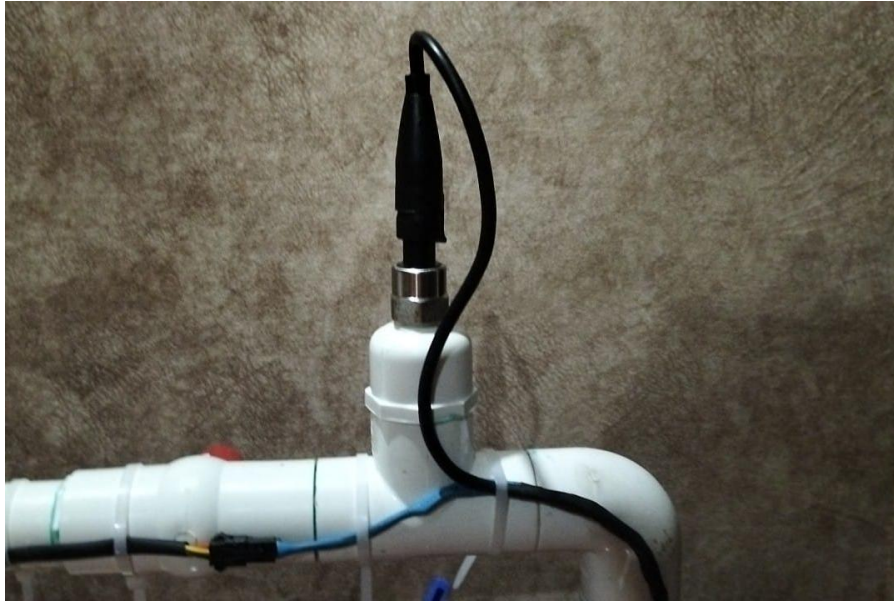
Figura 13. Transductor de presión instalado
