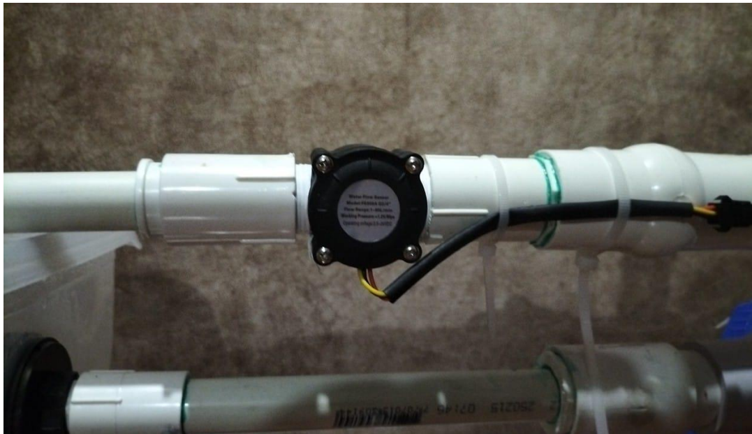
Figura 14. Sensor de caudal FS300A instalado
