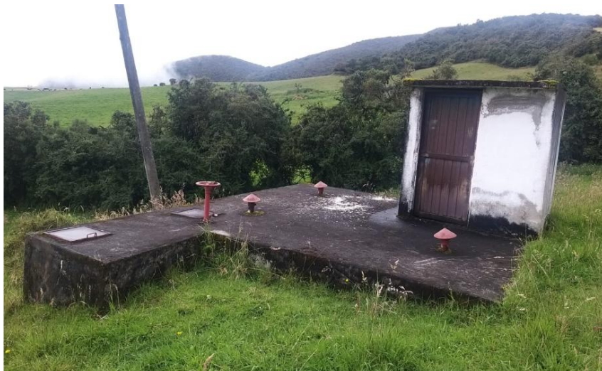
Fig. 6 Tanque de almacenamiento
